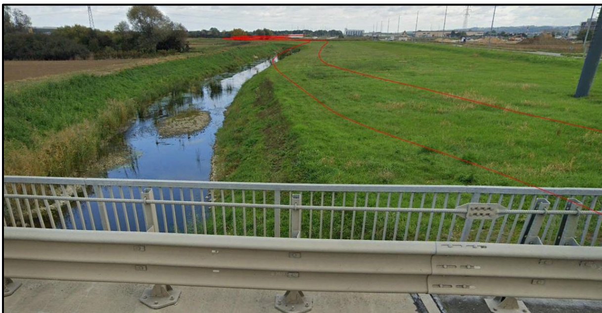
Slika 2.1-2. Pogled nizvodno na rijeku Plitvicu snimljen sa cestovnog mosta državne ceste DC2 (Varaždin – istočna obilaznica), stac. km 37+964, s označenim položajem zahvatom planiranog nasipa
