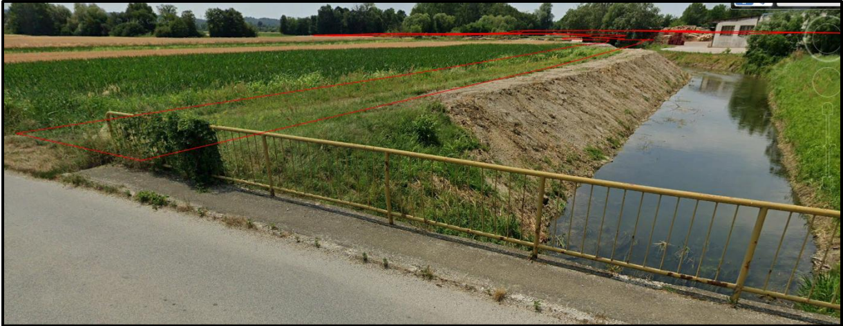
Slika 2.1-13. Pogled uzvodno na rijeku Plitvicu snimljen sa cestovnog mosta lokalne ceste LC25092 10 (cestovni most Hrastovljan), stac. km 20+450, s označenim položajem zahvatom planiranog nasipa
